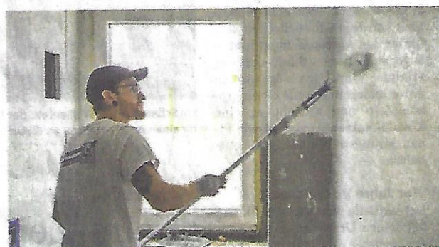
Julian Diesel vom Malergeschäft Lorenz aus Dothen (Thüringen) streicht eine Wand im Obergeschoss neu. FOTO: TOBIAS SCHLEGEL
