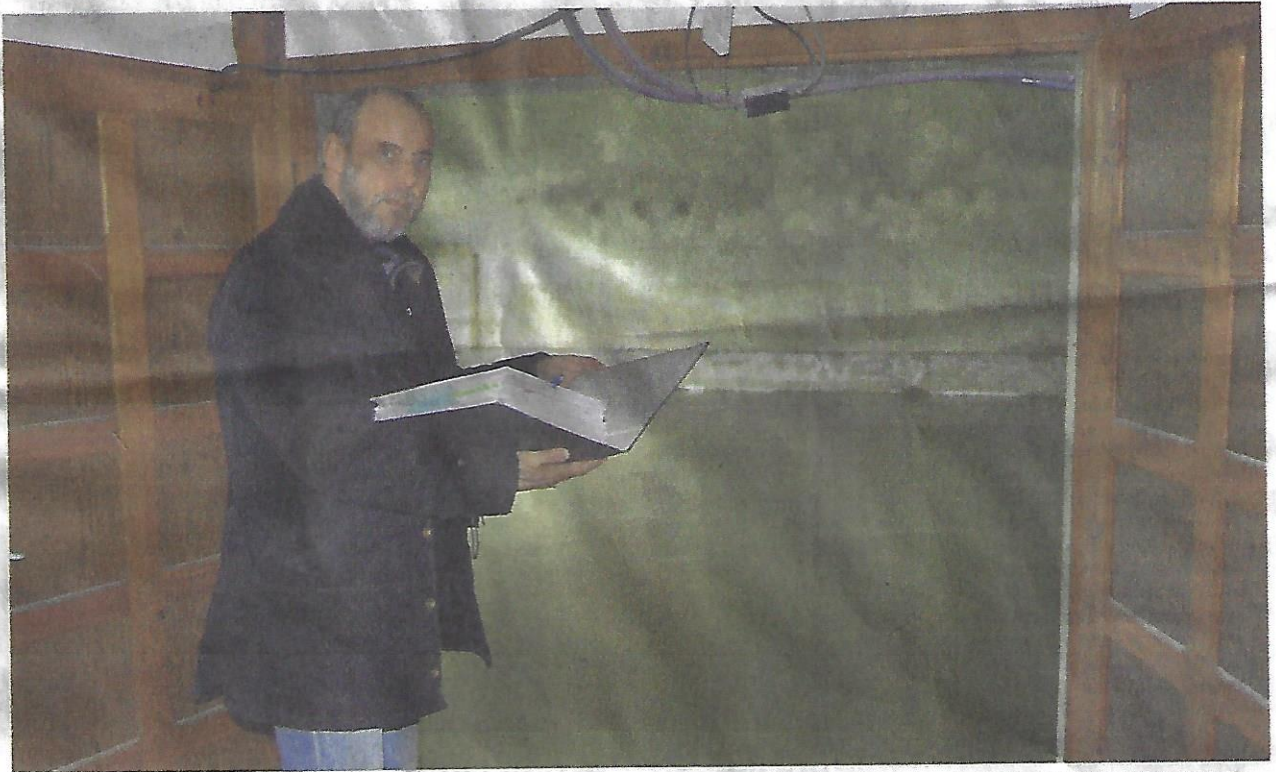
Hohenmölsens Bauamtsleiter Christoph Karger vor dem Festsaal im Volkshaus Taucha. Dort wurde jüngst der Unterbeton gegossen, aufgrund von Feuchtigkeitsschäden musste der Boden komplett erneuert werden. FOTO: TOBIAS SCHLEGEL
